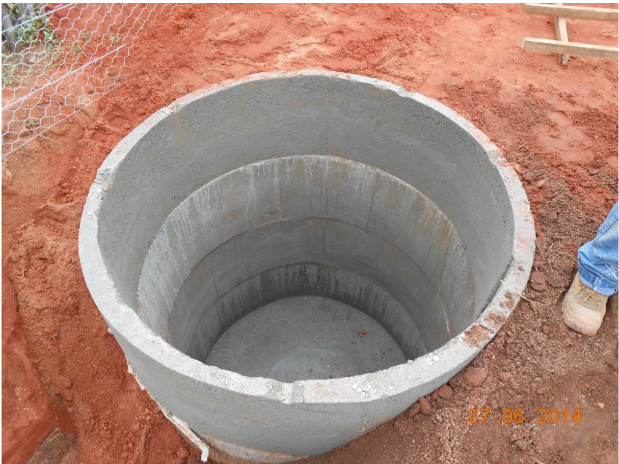
Figura 10. Tanque de armazenamento da água cinza tratada.
