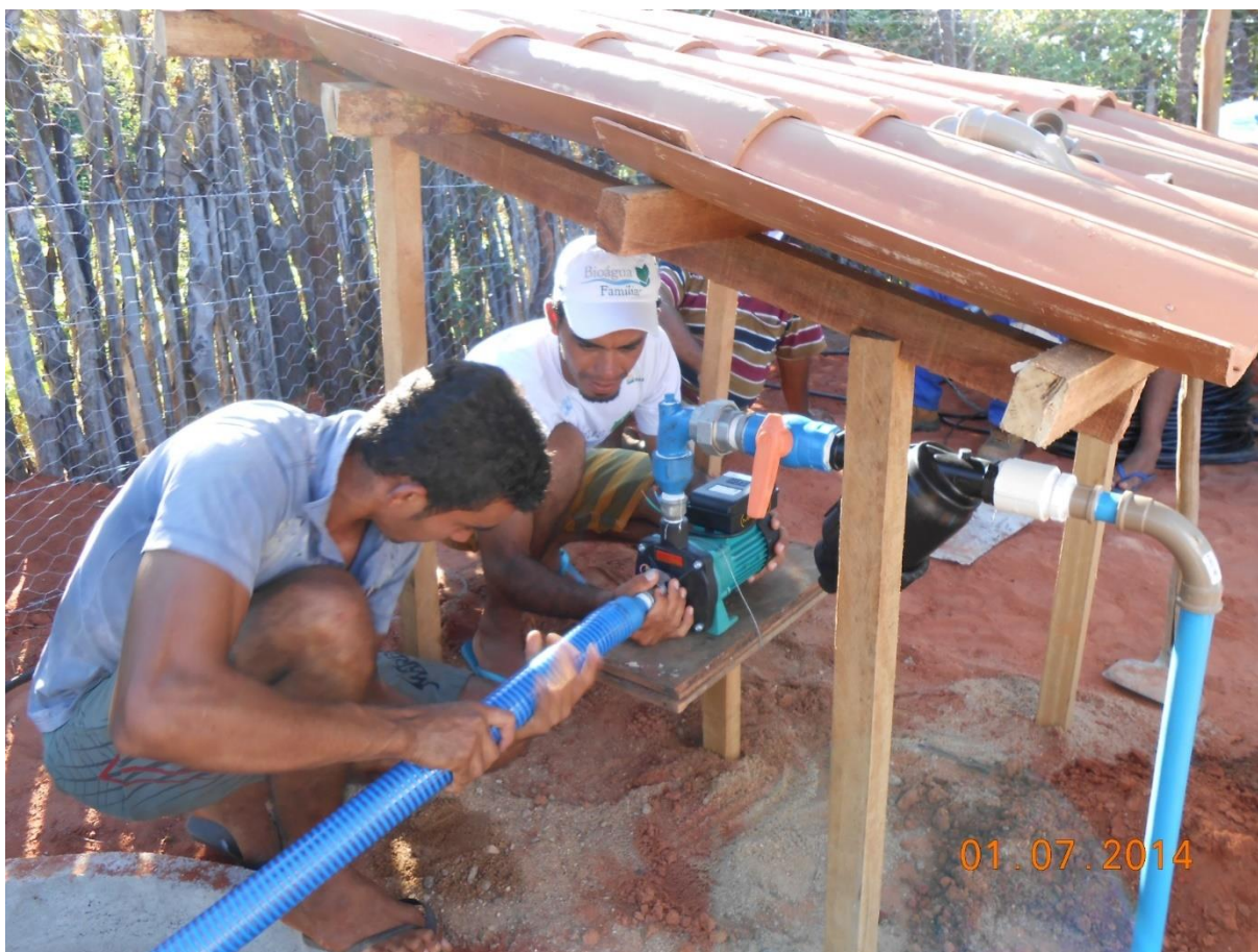
Figura 11. Detalhe da eletrobomba que pressuriza a água cinza tratada para o sistema de irrigação por gotejamento.
