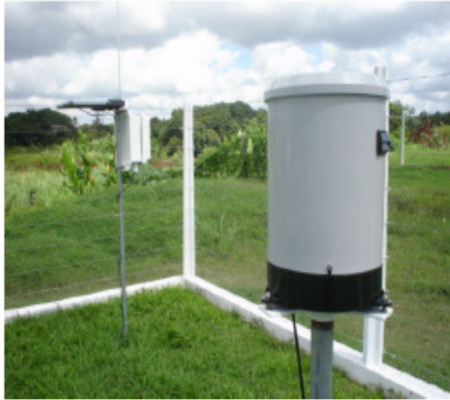
Figura 06. Vista parcial do pluviógrafo automático instalado na Estação Meteorológica da UFRPE
