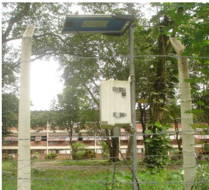
Figura 13. Estação linimétrica instalada na seção de deságüe da bacia
