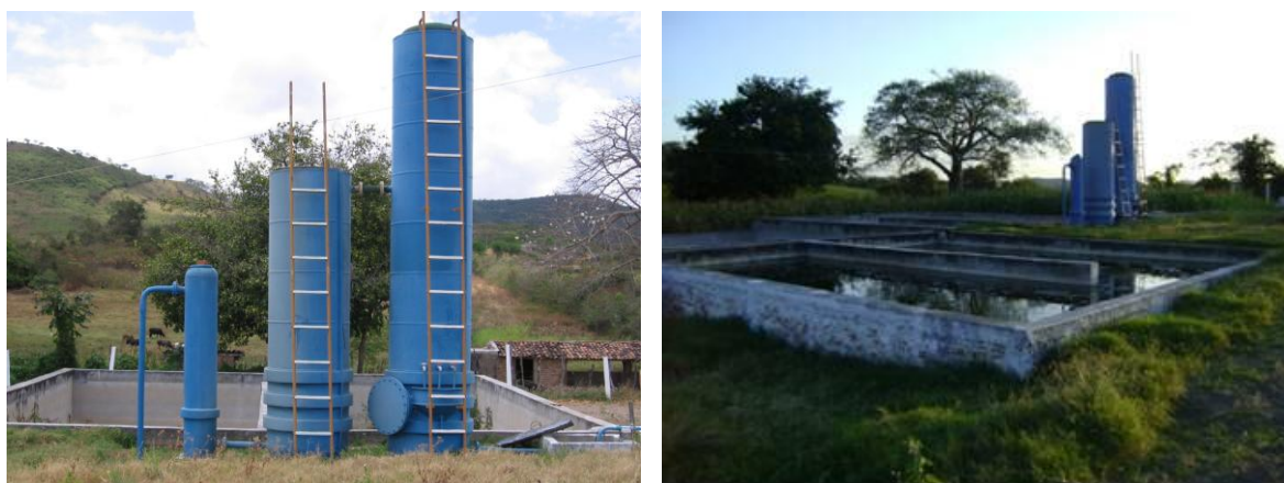
Figura 23 – Estação de tratamento de esgoto (ETE-MUTUCA)
