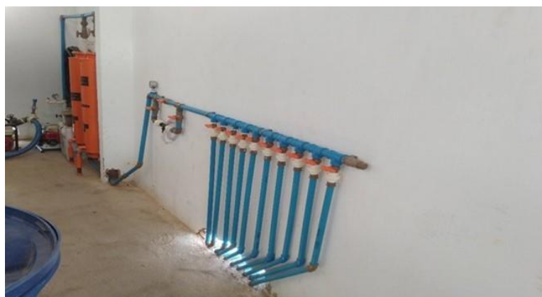
Figura 5. Cabeçal de controle do sistema de Irrigação
