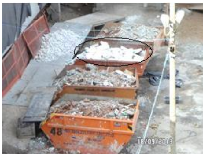
Figura 5: Indicação da caçamba de acondicionamento do resíduo de gesso coletado na obra
