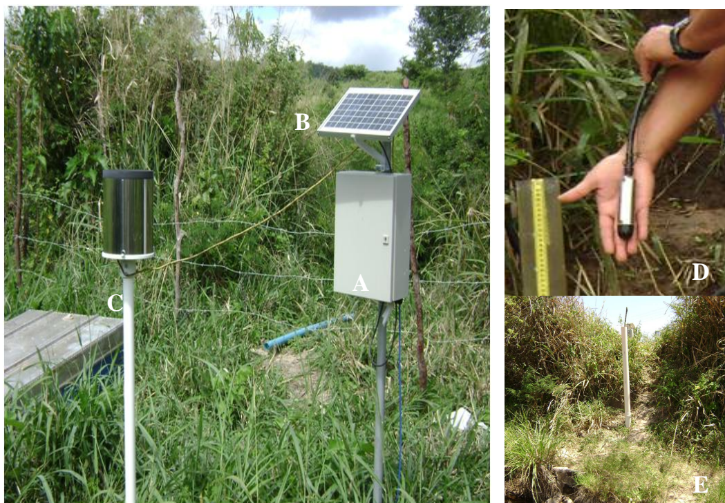
Figura 14. Detalhe da estação fluviométrica instalada na bacia do Riacho Mimoso, constando de Datalogger (A), célula fotoelétrica (B), pluviógrafo (C) e sensor de nível (linígrafo) (D), e poço tranqüilizador (E).
