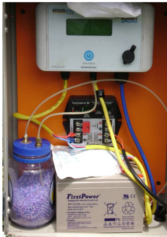
Figura 16. Garrafa de Mariotte instalada no sensor de nível.
